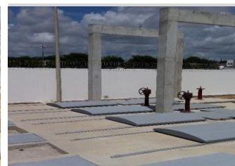
ELEVATÓRIA Foto 12 - Tampas de fibra 01 AN
