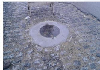
REDE COLETORA Foto 4 - Poço de visita com tampão de ferro
