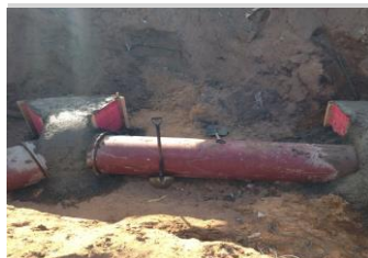
EMISSIONÁRIO Foto 6 - curva de 45° fôlo linha de recalque de 600mm
