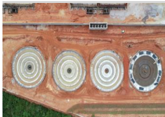
VISTAS Foto 11 - Visão geral dos decantadores
